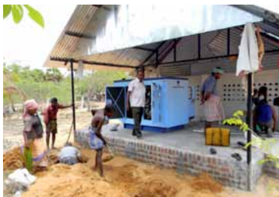
Ein eigener Stromgenerator macht das Palk Bay Center weitgehend unabhängig.
