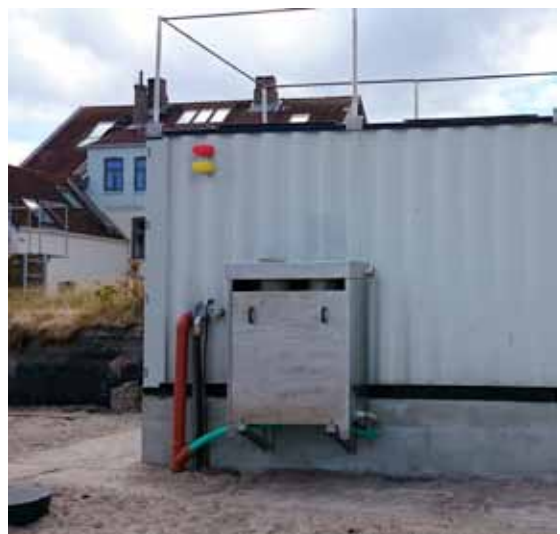
Die neue Kläranlage befindet sich in einem 20 Fuss Container auf hochwassergeschütztem Grund.
